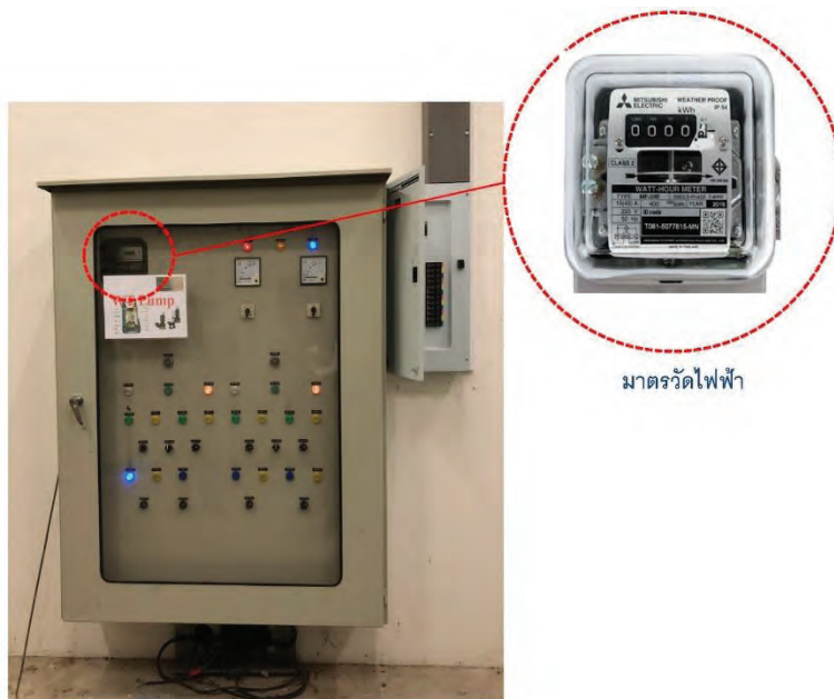
รูปที่ 77 ตัวอย่างการติดตั้งมาตรวัดไฟฟ้าของระบบบำบัดน้ำเสีย
