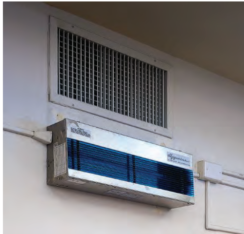
รูปที่ 64 การติดตั้งระบบ UVGI ชนิดติดตั้งที่ผนัง
