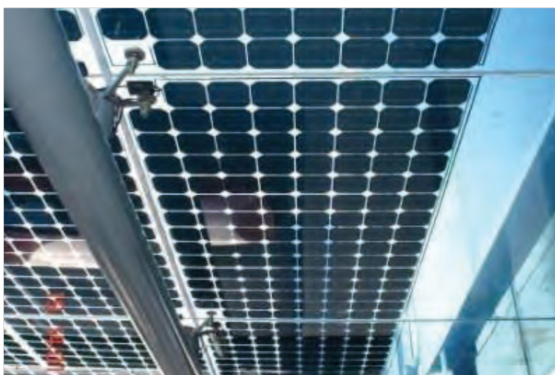
รูปที่ 90 การใช้ PV glass เป็น skylight และผลิตไฟฟ้าในขณะเดียวกัน
